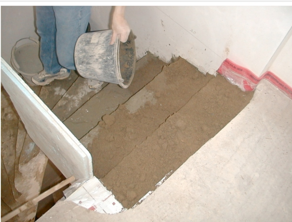
Bild 17: Estrichgemisch lose über die eingeschlämmt Stufen verteilen, um ein austrocknen der Schlämme zu verhindern.
