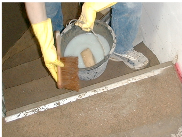
Bild 31: Auftritt einnässen, abreiben und glätten. Schwimmender Estrich mit nach unten durchgehenden Kellenschnitt vom Verbundestrich trennen.
