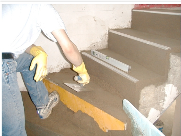
Bild 35: Erste Stufe im Schwenkbereich. Besonders zu beachten ist die Auftrittsbreite der Stufe in der Gehlinie.
